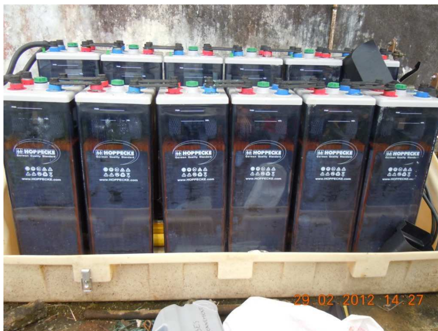
Figure 2 Parc constitués de 12 éléments de batteries ouvertes de 2V (Capacité 800 Ah - Tension 24 V)
